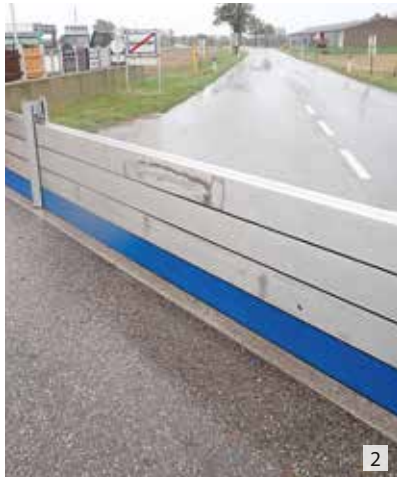
2 Der aufgebaute Hochwasserschutz
